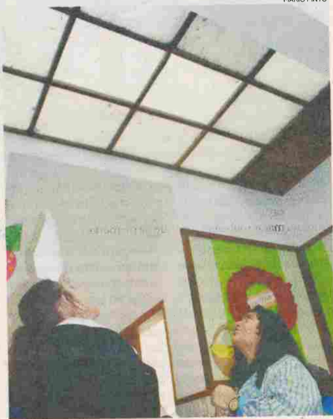
Reparação de clarabóia, que deixa entrar água para o interior da escola, é uma das intervenções consideradas urgentes
